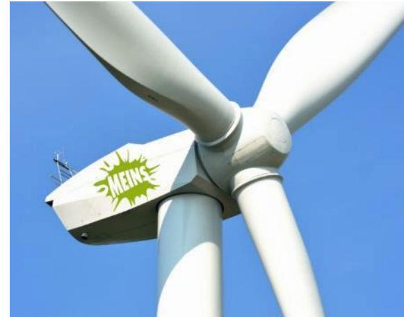
Windenergieanlagen Lustholz Beteiligung: 10 000 € Inbetriebnahme: 2015
